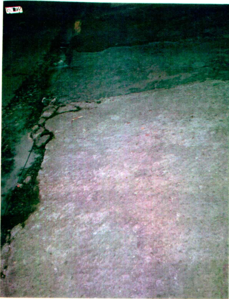
Pavimento inadecuado en la acera.
