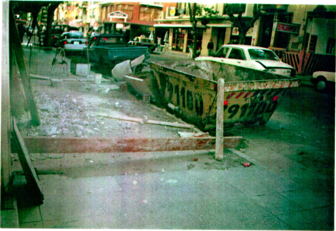
Obra en construcción con señalización inadecuada.
