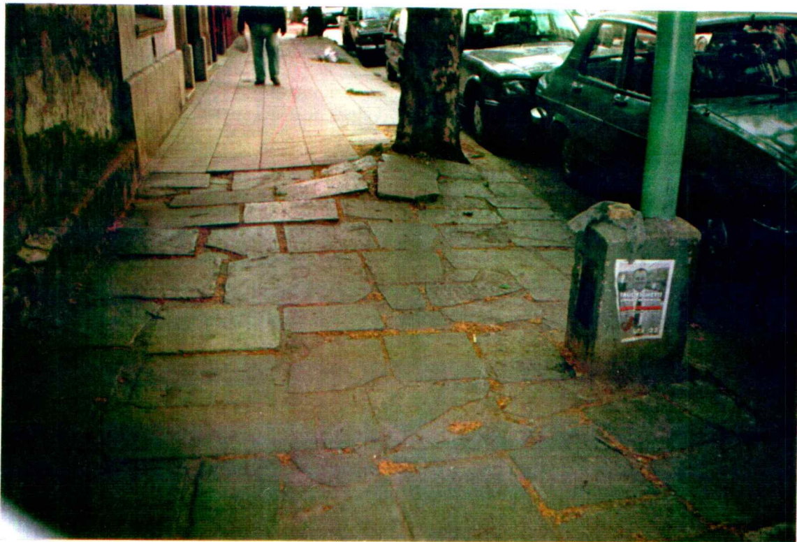
Baldosas de material inadecuado, mal colocadas y por la presencia de raíces provocan desniveles.
